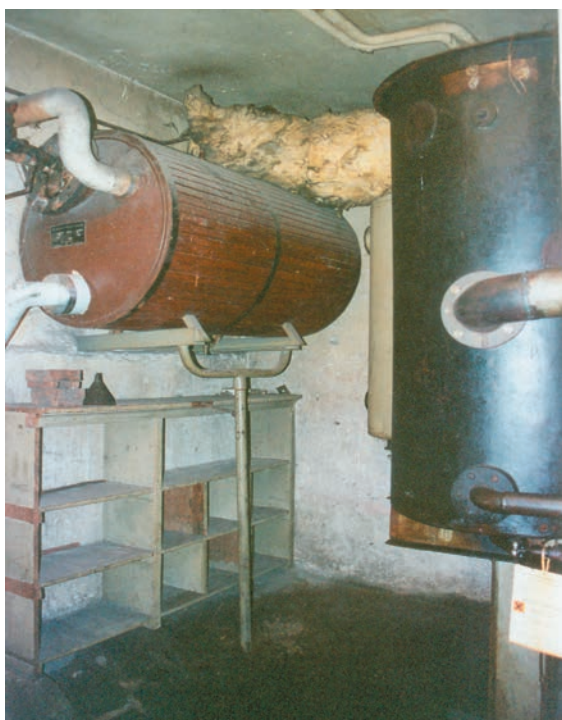
Rum 008 med äldre varmvattenberedare och oljepanna. 2004.
