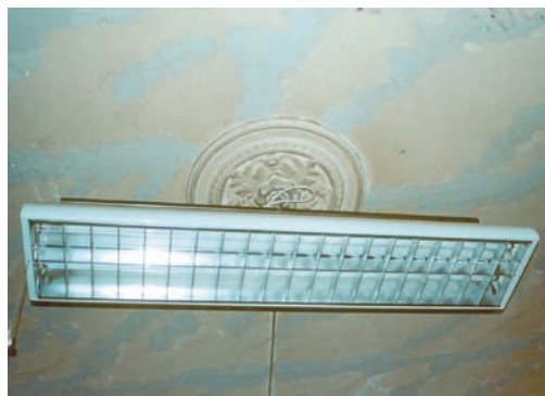
Rum 121 med takrosett och lysrörsarmatur. 2004
